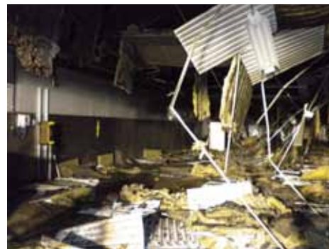
Sådan så bygningen ud indvendig efter røg-/støvgaseeksplosionen
